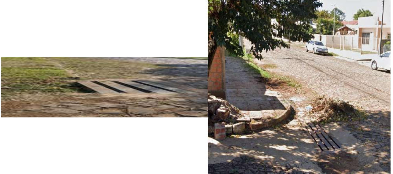
Figura 25 – Boca de lobo com grade na rua Félix da Cunha e rua Riachuelo
