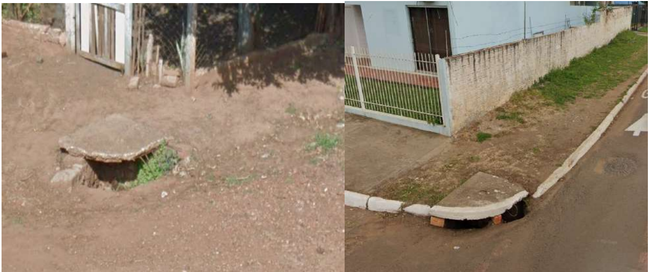
Figura 26 – Boca de lobo com caixa coletora nas ruas Bompland e Pinheiro Machado
